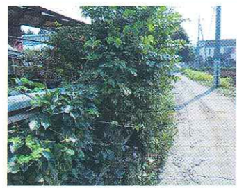
境界線樹木繁茂状態の確認
